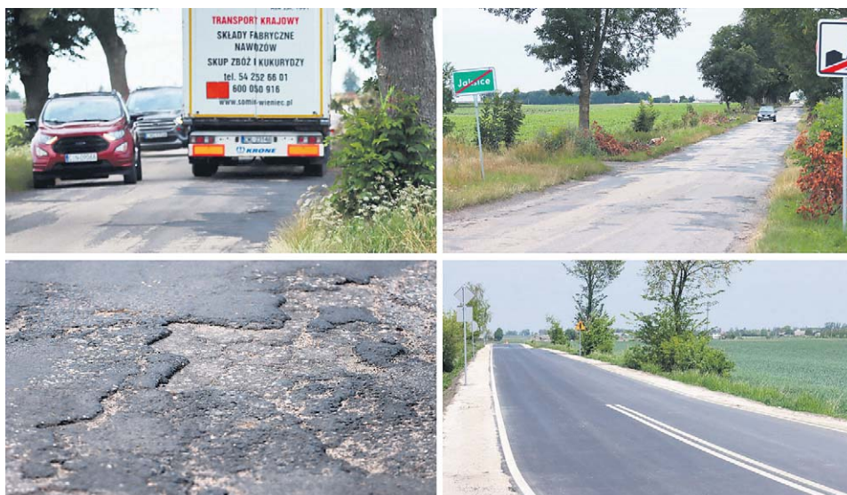
Planowane do remontów drogi są obecnie wąskie i w kiepskim stanie technicznym. Niebawem będą wyglądały, jak ta w Helenowie (fot. w prawym, dolnym rogu).
